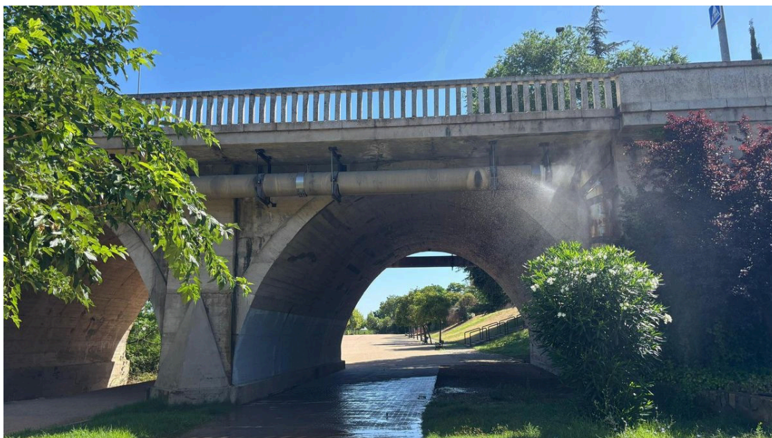
Imagen de una de las incidencias sufridas en el puente de la Universidad de Badajoz.
