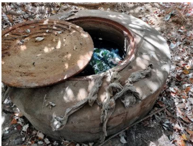
Una de la laguna de aguas fecales que ha producido el vertido y otra de un pozo del alcantarillado que está a unos 20 metros del pozo (similar) que está vertiendo ahora.
